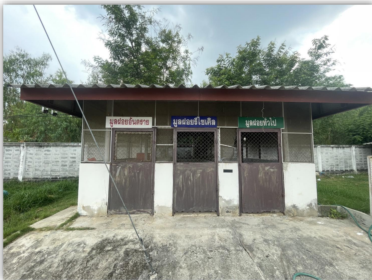
สถานที่พักรวมมูลฝอย
