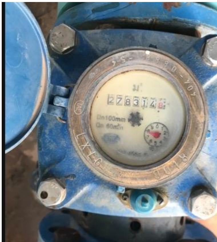
มิเตอร์ที่ใช้จดบันทึกการใช้น้ำประปาภายในโรงพยาบาล
