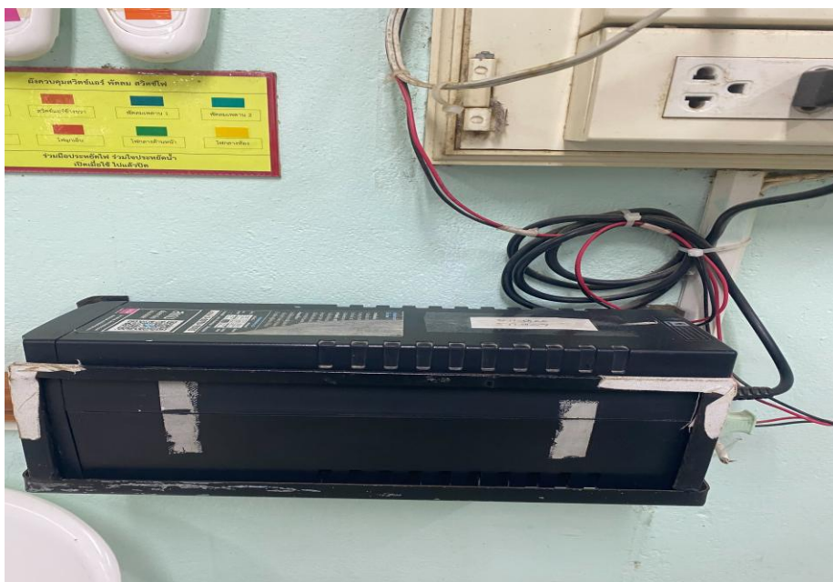
ระบบสำรองไฟฟ้า
